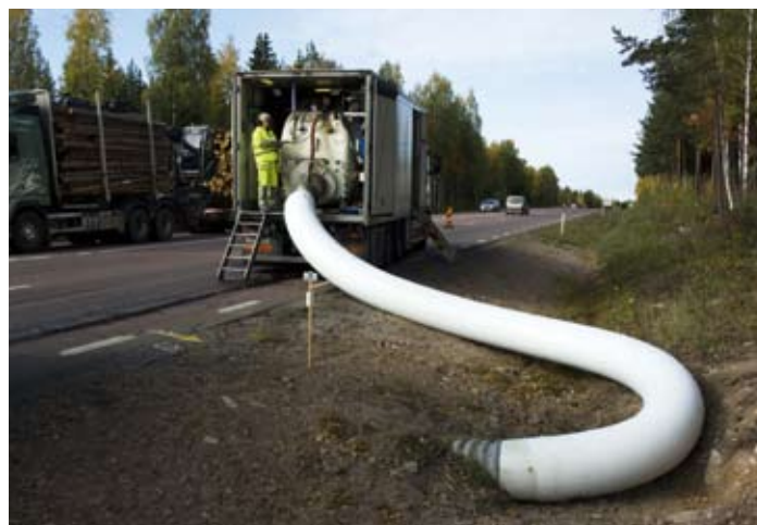
Aarsleff Rörteknik relinar en slitna trumma mellan Rättvik och Mora. Vägverket uppskattar den metod som Aarsleff Rörteknik erbjuder.
