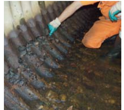
En vägtrumma före renovering. En trumma av plåt har en livslängd på cirka 40 år.
