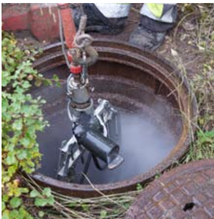
Med ett specialverktyg förbereder vi brunnen genom rengöring och borttagning av betongrester.
